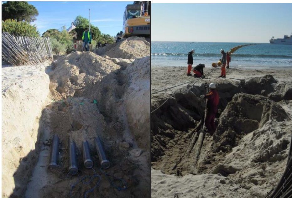
Figure 15 : Illustration de l'installation de conduites d'accueil en haut de plage (à gauche), puis de conduites dégagées à l'occasion de la réception d'un câble (à droite)
