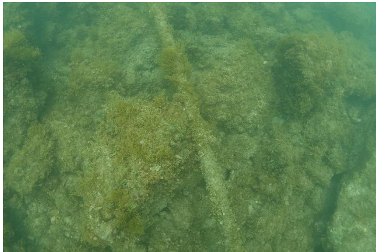
Figure 77 : Câble télécom sur des enrochements (Marseille, 2020)
