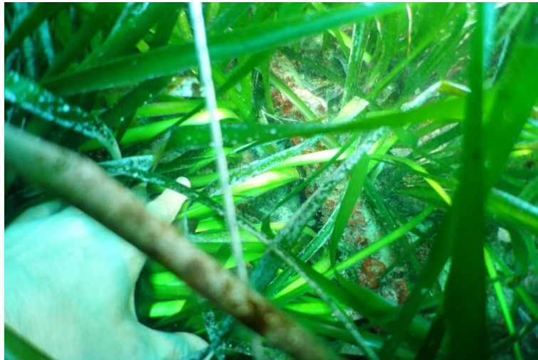
Figure 76 : Câble télécom au sein d'un herbier entre les faisceaux de posidonie (Marseille, 2020)
